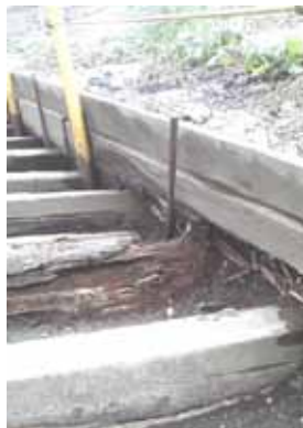
対策が急がれる 階段通学路
