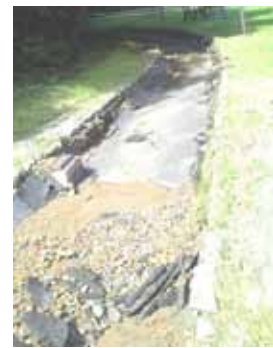
陥没した南公園道路 昨年8月22日撮影
