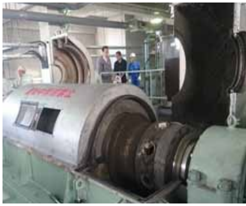
浄化センターの機器
